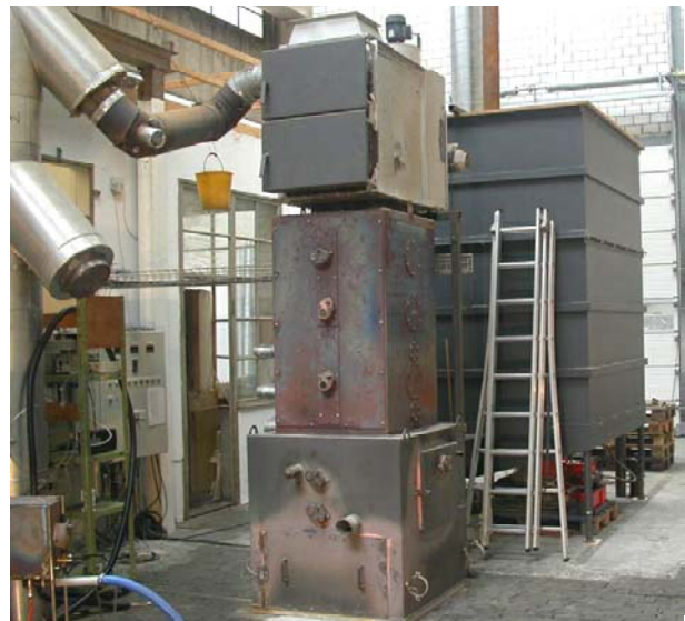
Bild 14: Funktionsmuster eines 240 kW Schnitzelkessel im Prüfstand
