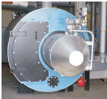
Bild 6 schwedischer 1000 kW Pelletbrenner (TPS)
