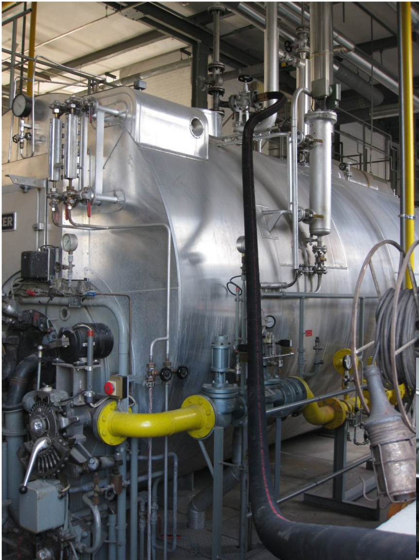
Sulzer-Dreizugkessel mit Gasfeuerung
