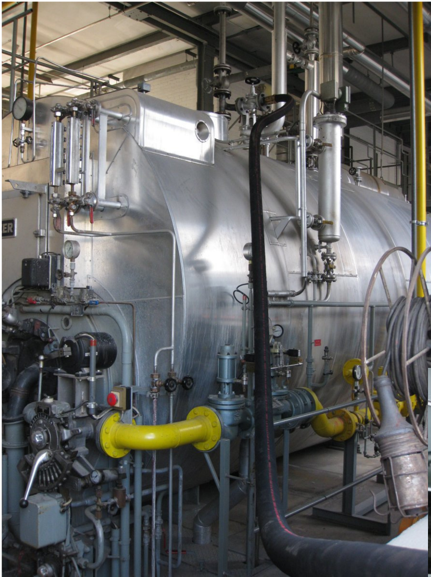
Sulzer-Dreizugkessel mit Gasfeuerung
